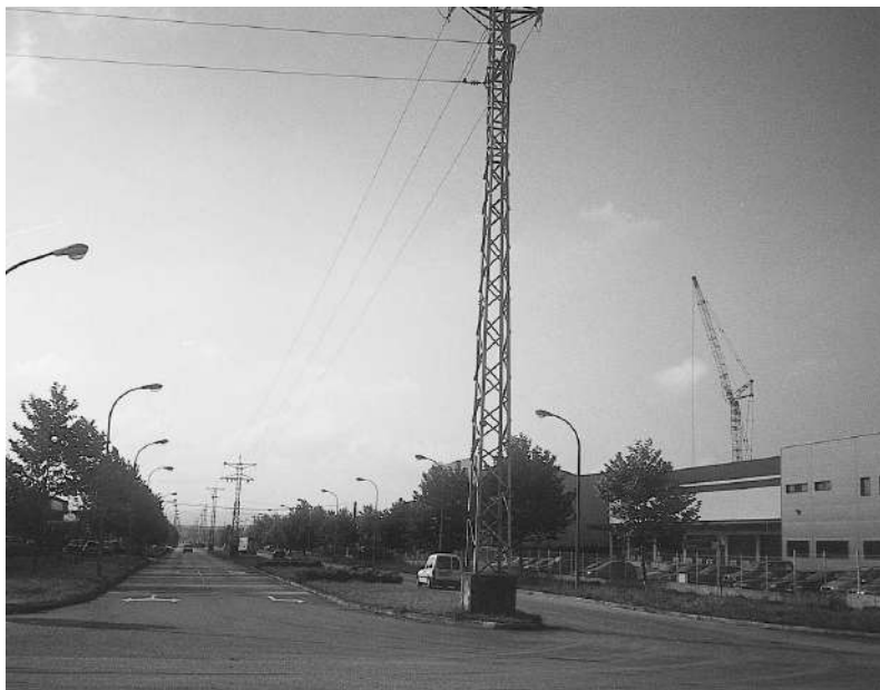
Pal elèctric sense protegir
